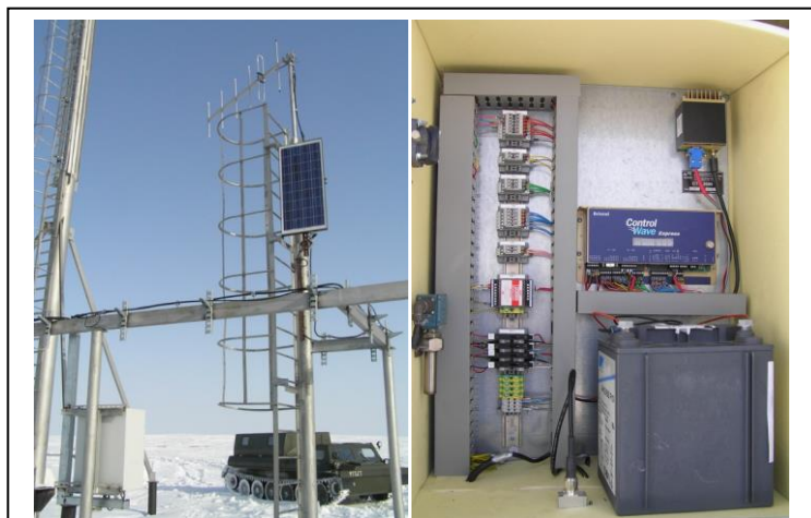
Рис. 5. Система телемеханики кустов газовых скважин Западного купола Северо-Уренгойского ГКМ
