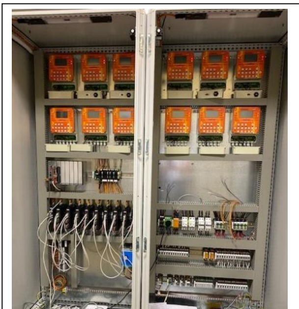
Рис. 5. Шкаф БОИ с установленными устройствами для стыковки с вычислителями расхода газа
