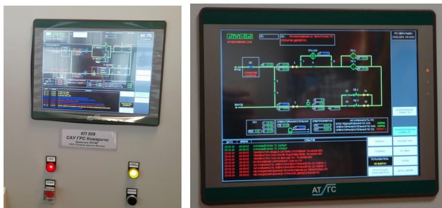
Рис. 6. Панель оператора производства АО «АТГС» (справа), установка панели и кнопок экстренного останова ГРС на двери шкафа САУ ГРС СТН-3000-Р (слева)
